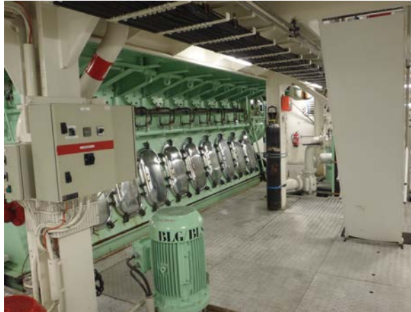
Figure 2.4.: Ciudad de Sevilla Engine Room.
